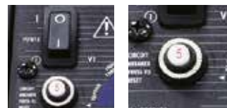
Interruttori coperti e interruttore di sicurezza
